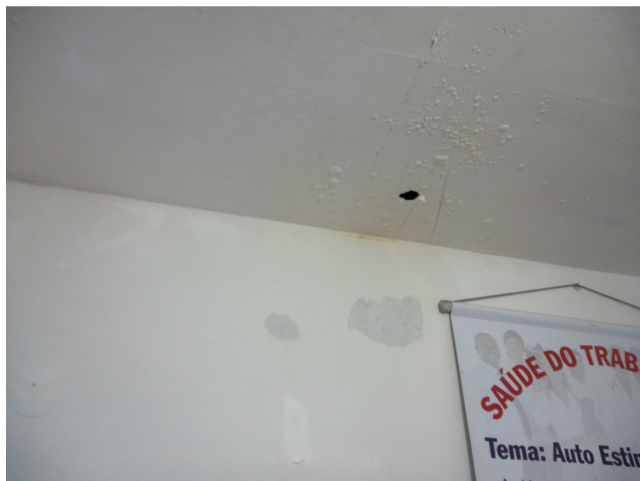
26.1. Instalações com mofos e/ou infiltrações, reboco caindo
