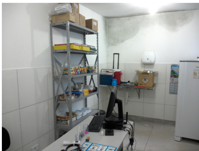
26.9. Dispõe de sala de imunização / vacinação (observar infiltração)
