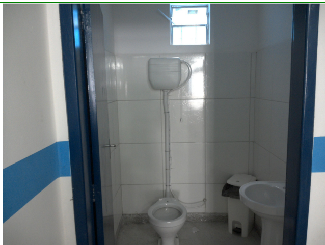
26.3. Banheiro para deficientes não atende às normas
