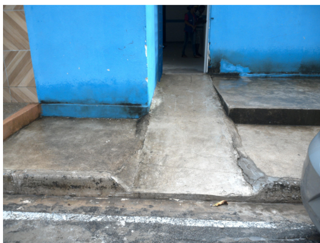
26.2. Acesso à unidade com obstáculos
