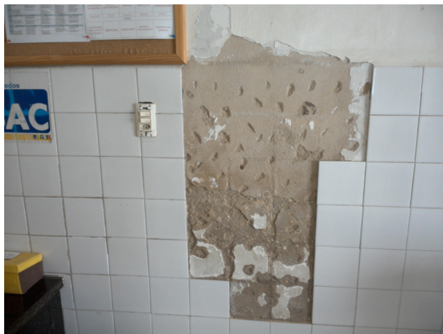
28.1. Instalações prediais com problemas de infraestrutura apesar da reforma
