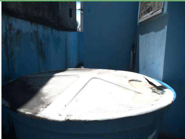
28.18. Caixa que armazena a água da unidade, tampa quebrada
