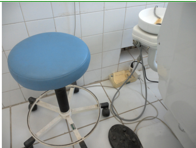
28.3. Instalações elétricas não compatíveis com a segurança do paciente
