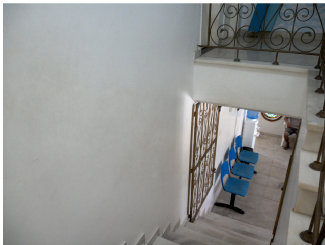
4.1. Escada sem corrimão
