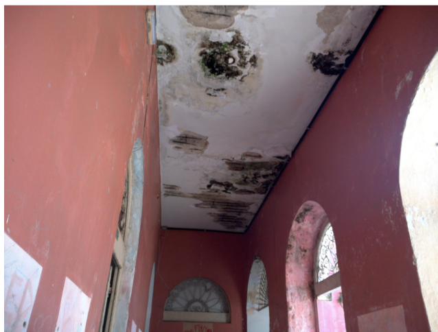
24.12. Corredores com infiltração
