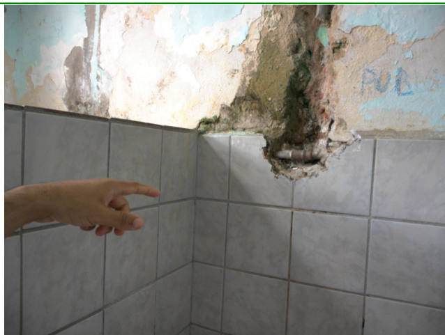
24.13. Parede com buraco na estrutura
