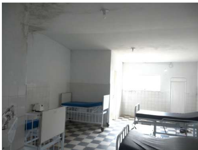
33.6. Sala de observação exclusiva da pediatria (observar infiltração)
