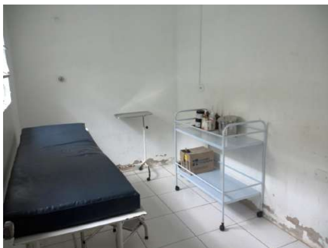
33.7. Sala de curativo (observar parede com reboco caindo)
