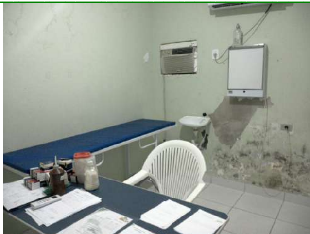
33.11. Consultório médico (observar precariedade da infraestrutura da parede)
