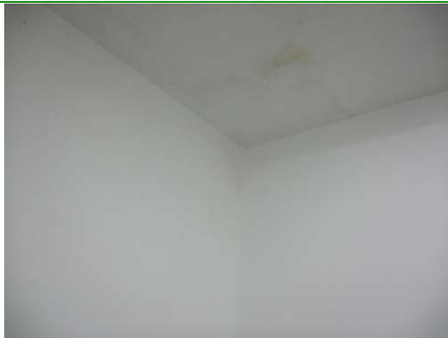
21.48. Consultório 02 - sinais de infiltração
