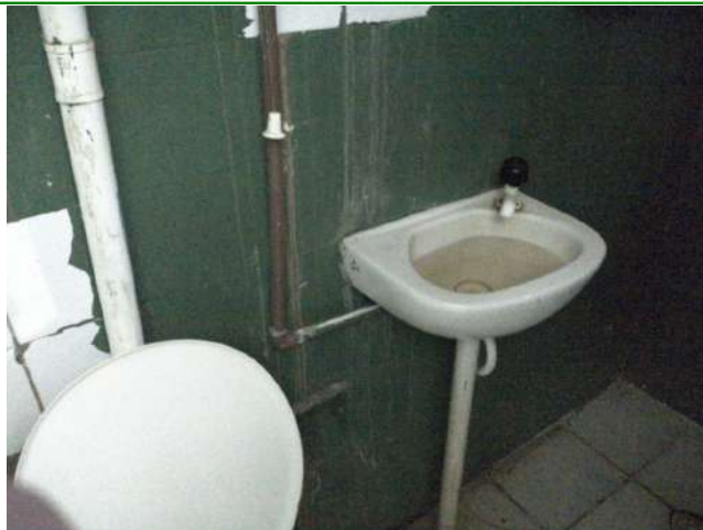
17.18. Banheiro com pia sem dispensador de sabão líquido nem de toalha de papel.
