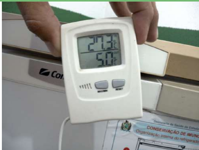
17.8. Sala de vacinas
