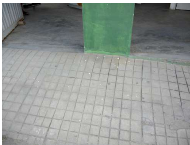
22.2. Piso com várias irregularidades
