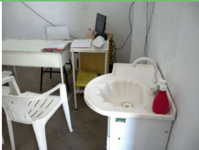
22.25. Sala de vacinas com pia sem dispensador de sabão líquido e sem dispensador de papel toalha. Há fiação exposta.
