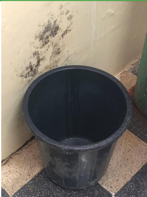
29.33. Sala Vermelha Infiltração e Mofo
