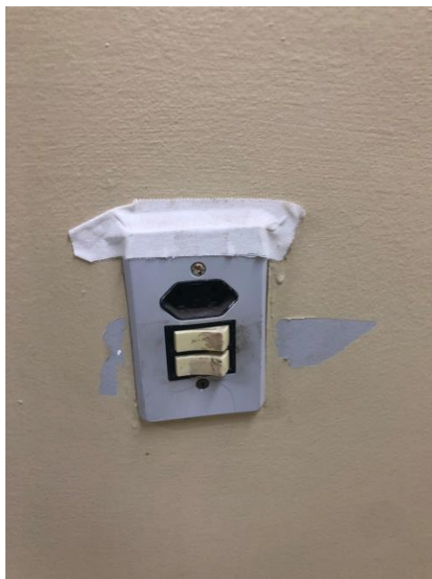
29.16. Instalações Elétricas precárias
