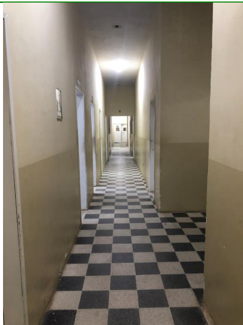
29.35. Corredor principiapl sem extintor de incêndio
