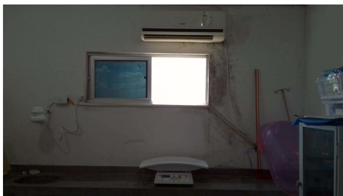
25.12. Sala de parto (observar infiltração)
