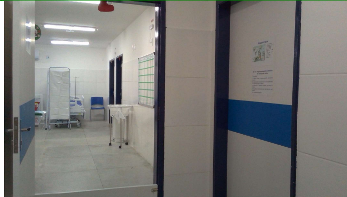
26.22. Entrada do bloco (à esquerda) e entrada da sala cirúrgica (à direita), dimensões dificultam a entrada da maca na sala de cirurgia
