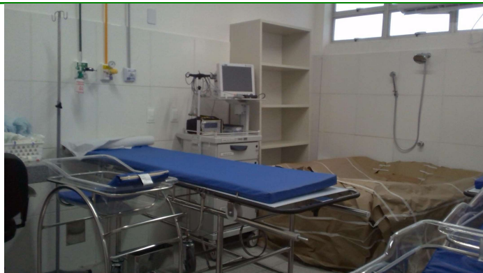
26.28. SRPA (observar banheiro no meio, dificuldade para circulação da equipe, apenas macas e sem berço aquecido)
