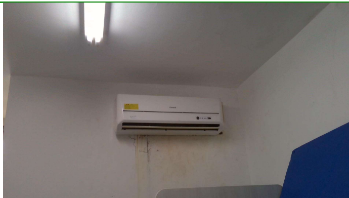
26.4. Infiltração em parede ar condicionado
