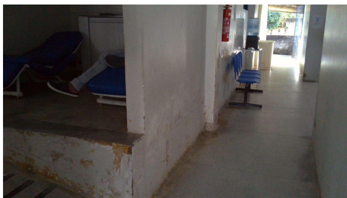
22.9. Paredes com reboco caindo
