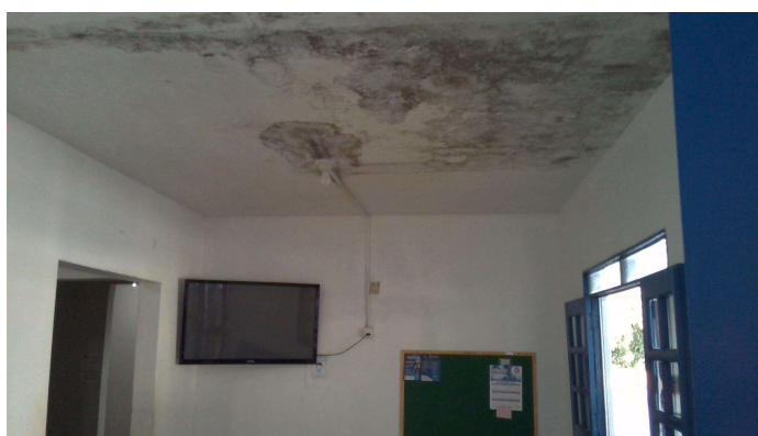
22.11. Infiltração no teto
