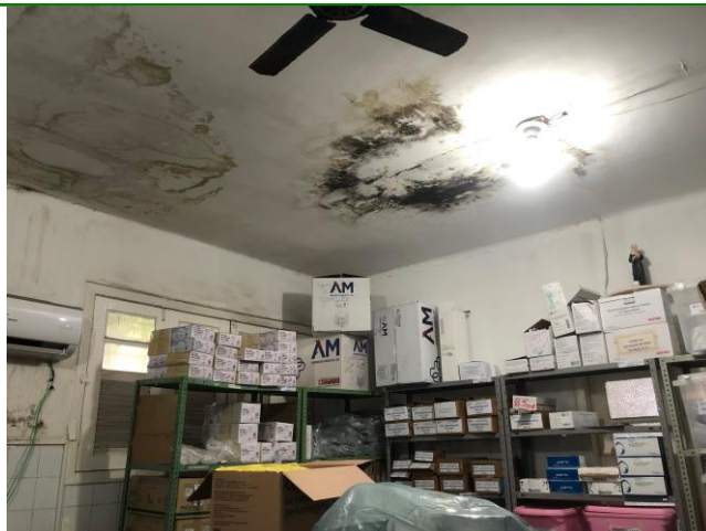
13.13. Farmácia ( infiltração no teto e parede)
