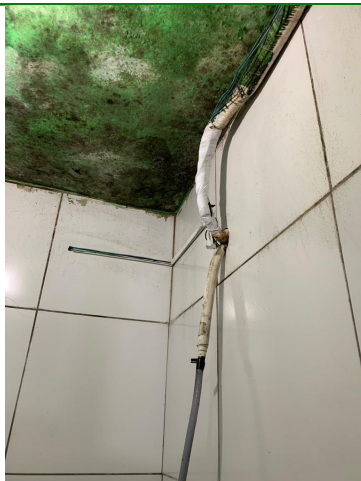
28.76. Setor Administrativo Mofo Banheiro
