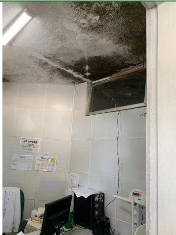
28.8. Classificação Risco Sem Pia e Mofo
