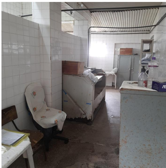
29.18. Lavanderia com rotinas inseguras, sem telas nas janelas, com forro precário e funcionárias sem EPI
