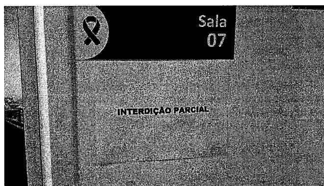
21.27. SALA 7 - interdição por conta de condensação de ar-condicionado.
