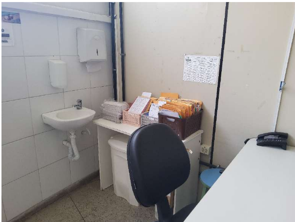
Item não conforme: O local de guarda, garante a preservação do sigilo
