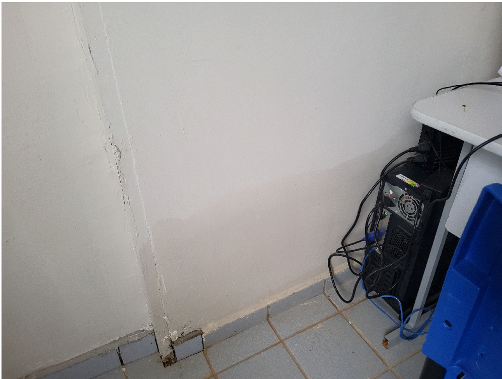
Infiltração no consultório médico
