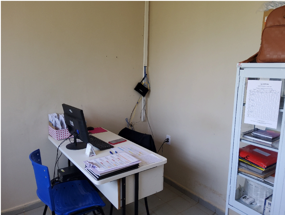
Sala de vacina (foto 2 - observar fios aparentes)
