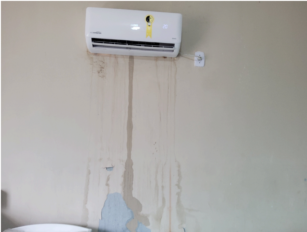
Sala multiuso (observar infiltração e ar-condicionado vazando)
