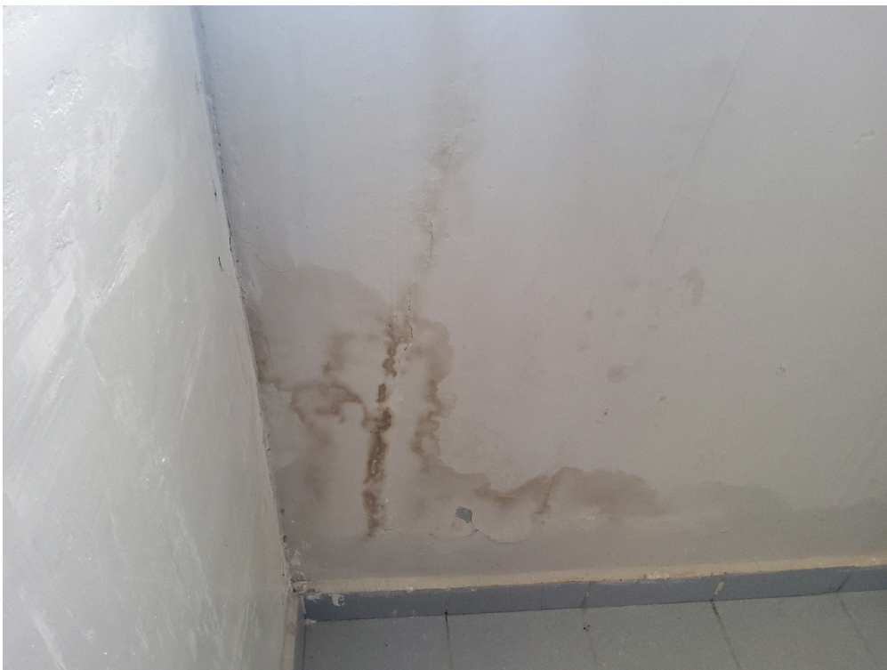
Infiltração na sala de vacina
