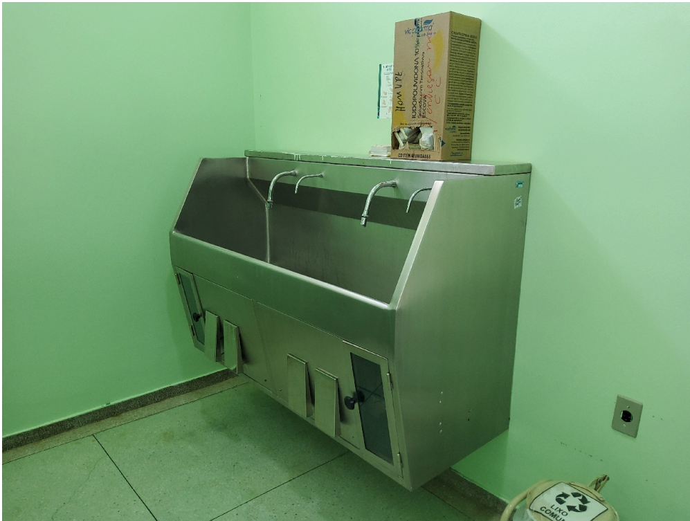
Lavabo com acionamento automático
