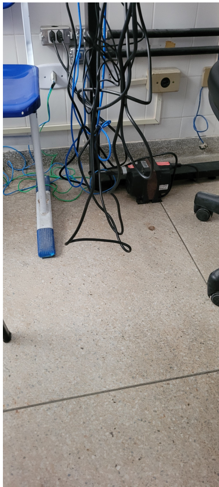
instalações elétricas inseguras
