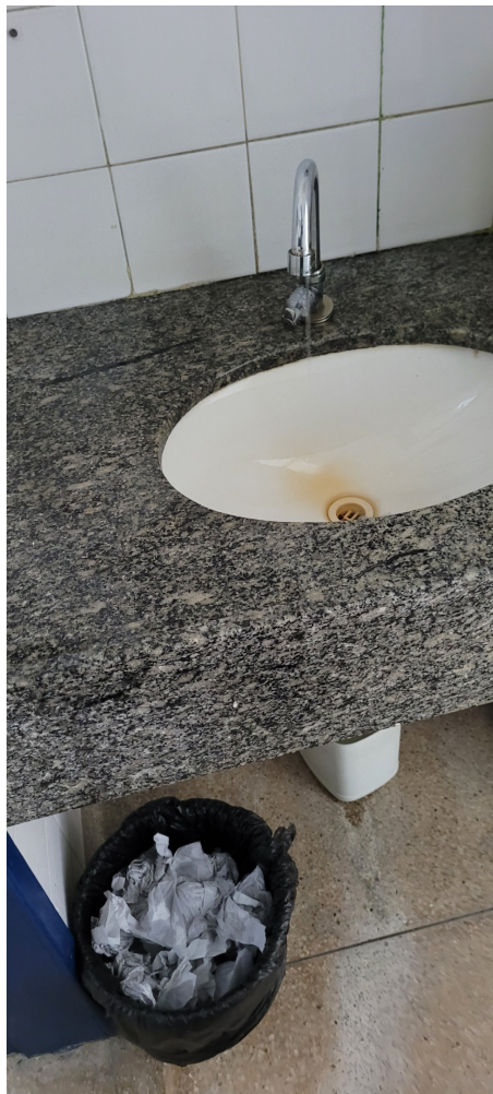
pia dos banheiros com vazamento e lixeira sem tampa
