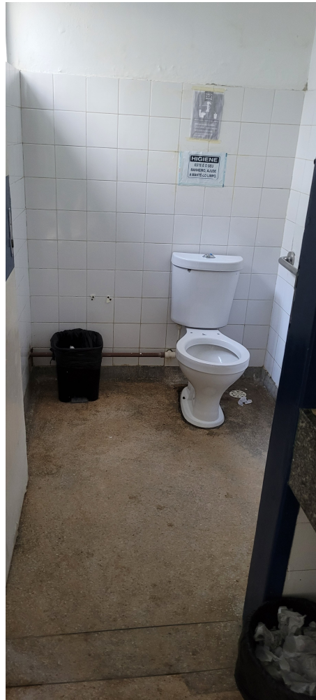
vaso sanitário sem tampa no banheiro dos usuários
