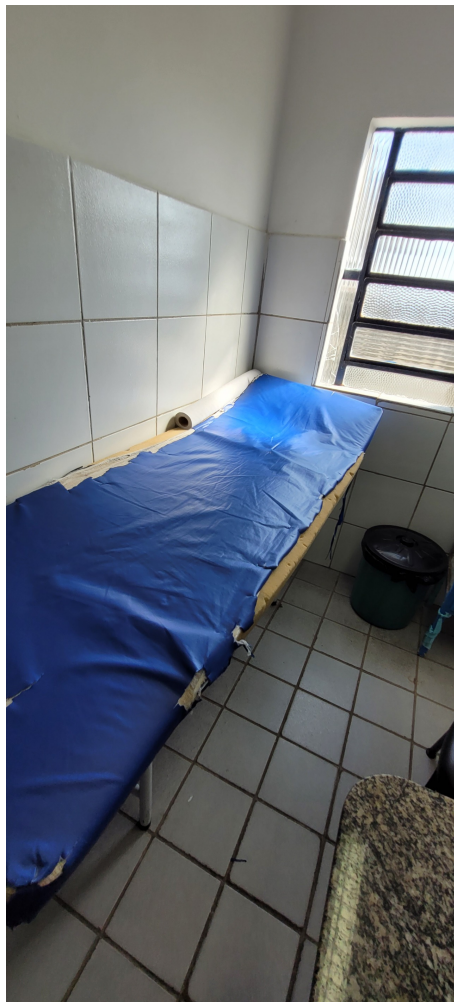
colchão em um dos consultórios com forro rasgado
