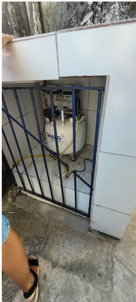
compressor odontológico instalado no abrigo do lixo
