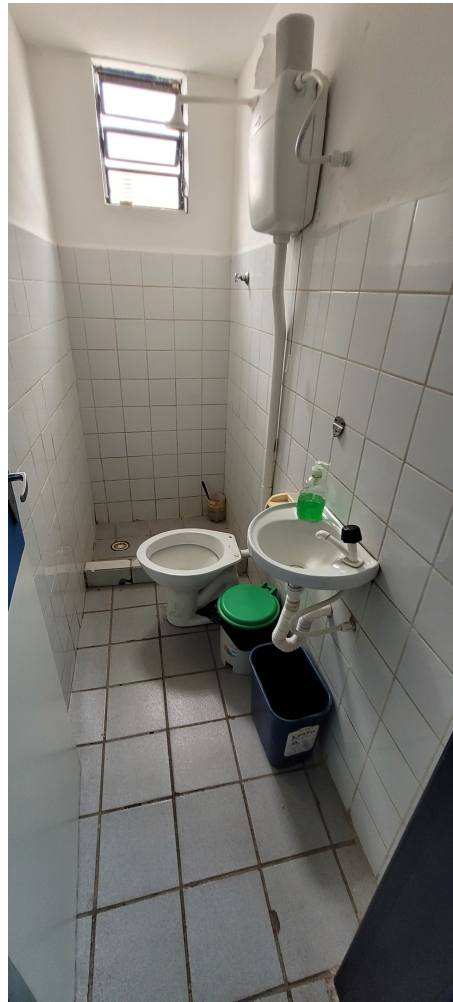
banheiro com vaso sem tampa
