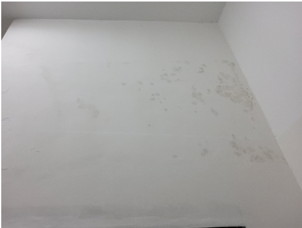
Infiltração na parede do bloco cirúrgico
