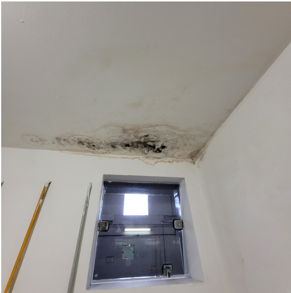
área com infiltrações e mofo em um dos consultórios
