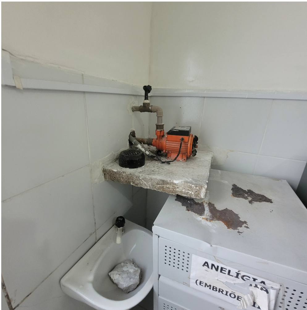
a bomba de água da unidade fica dentro da sala dos dos agentes comunitários de saúde
