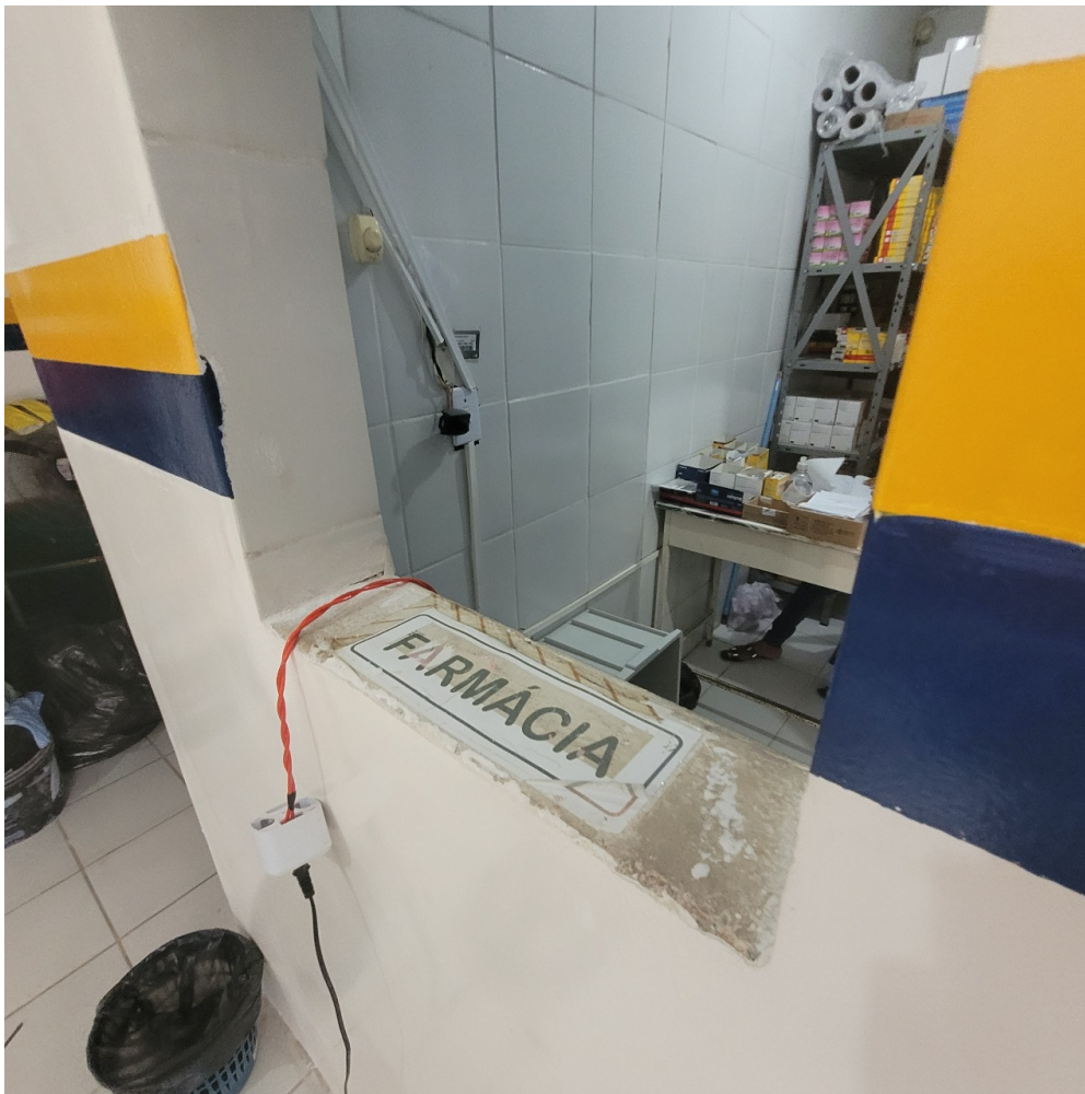
janela para dispensação de medicamentos com extensão elétrica passando
