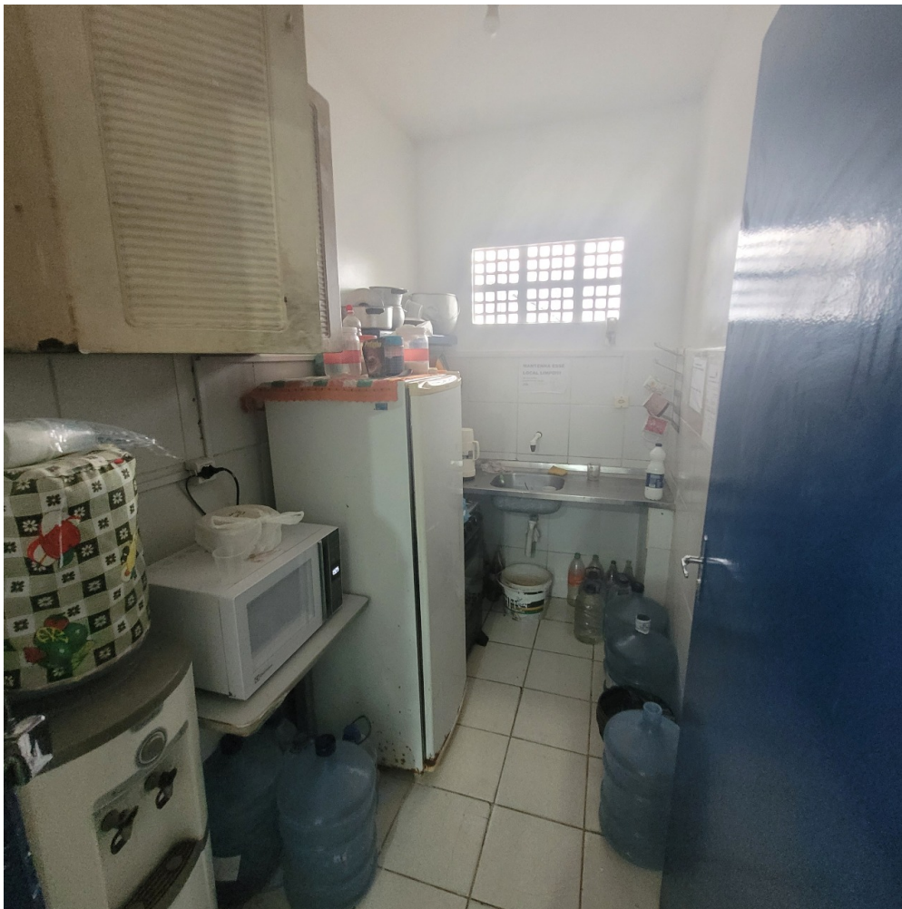
Copa cozinha com garrações depositados no chão e sem climatização
