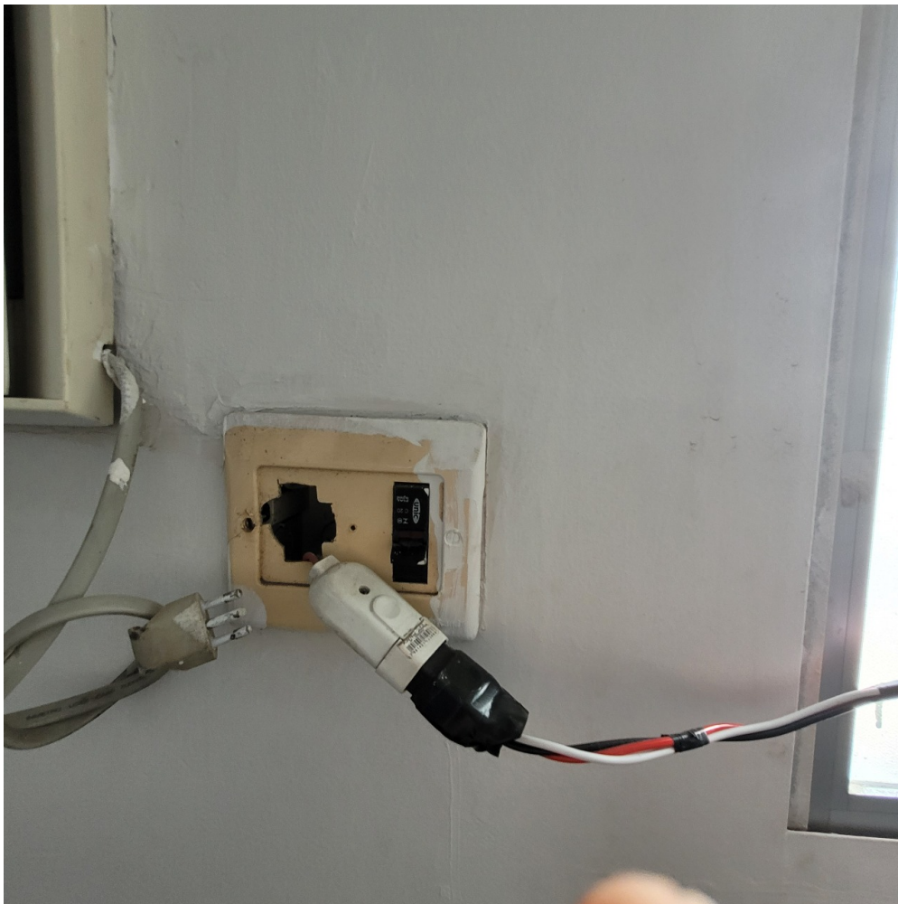
instalação elétrica em segura no aparelho de ar condicionado do consultório médico
