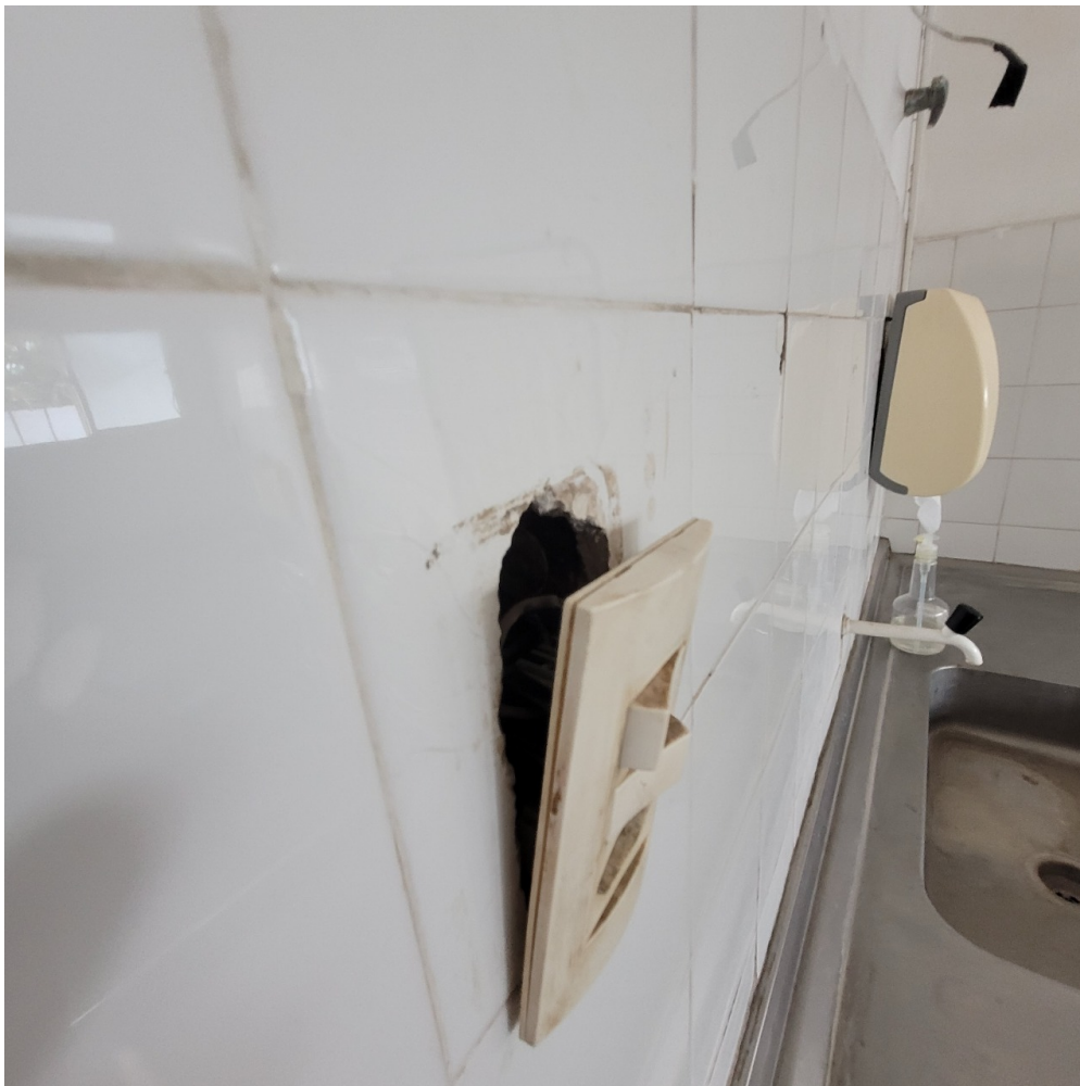
caixa de interruptor com fiação exposta
