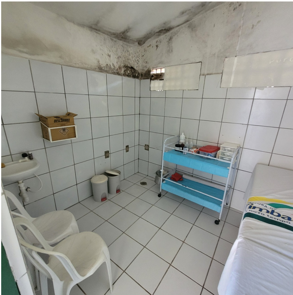
sala de curativos/procedimentos com infiltração e mofo em teto
