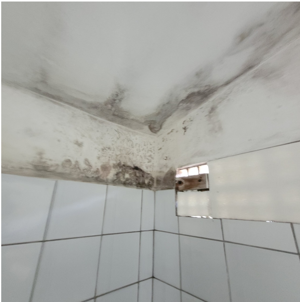
infiltração e mofo da sala de curativos em detalhes
