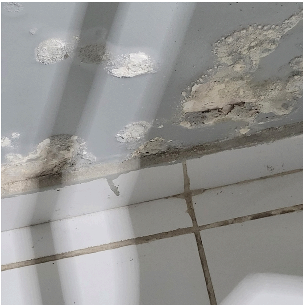
áreas de infiltração e mofo comuns em vários ambientes da unidade
