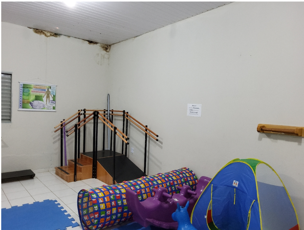
Sala de fisioterapia (foto 1) - observar infiltração no teto
