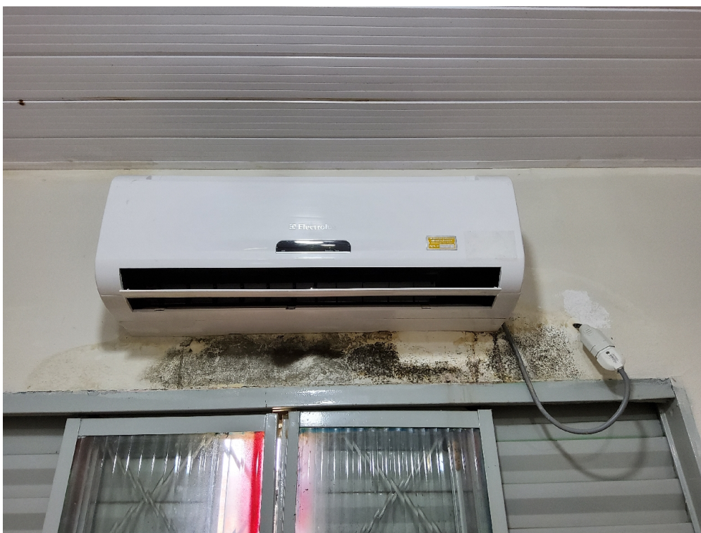
Infiltração no consultório da psicologia
