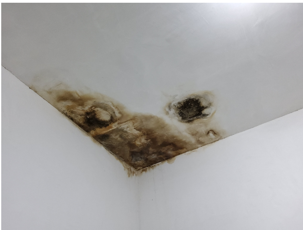
Infiltração no teto
